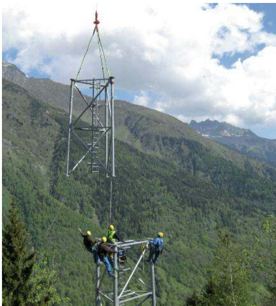
7.6-2 Application de produits galvanisés : pylônes
