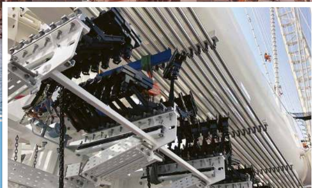
Un des blocs à structure métallique abritant les conducteurs électriques
