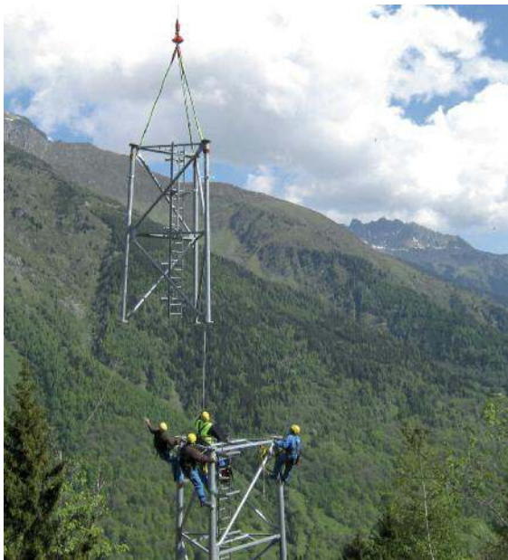
7.6-2 Application de produits galvanisés : pylônes
